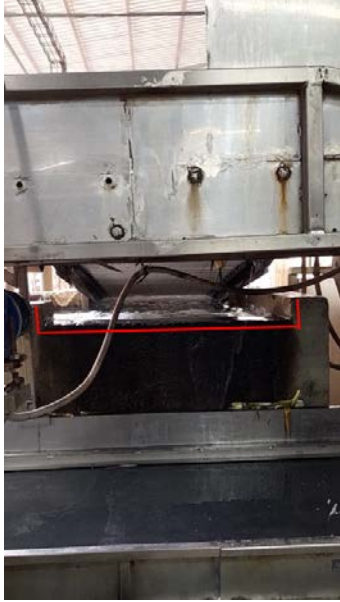
Figura 32. Fuga de agua en infraestructura de la pila de lavado
