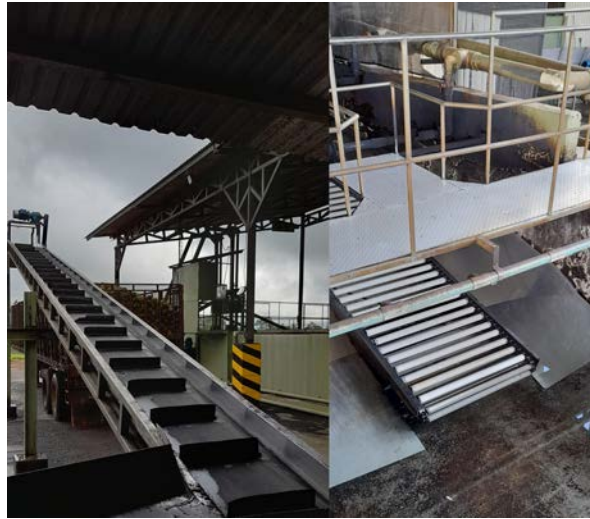
Figura 42. Opciones de bandas de transporte para mejor efectividad en la etapa de descarte
