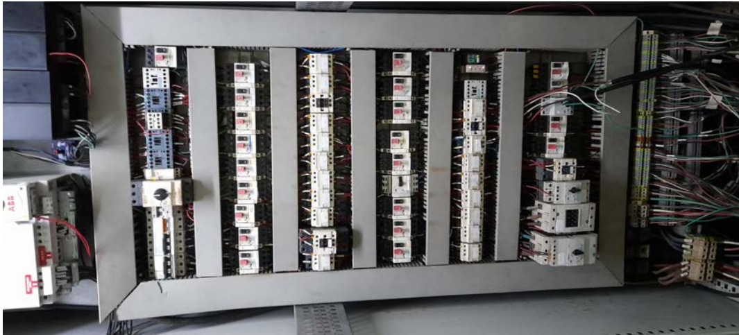
Figura 57. Panel de control de motores.
