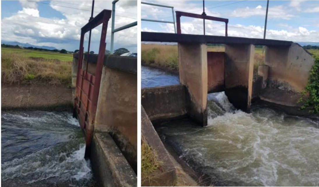
Figura 16. Ejemplo de presa con compuerta utilizada en el DRAT.
