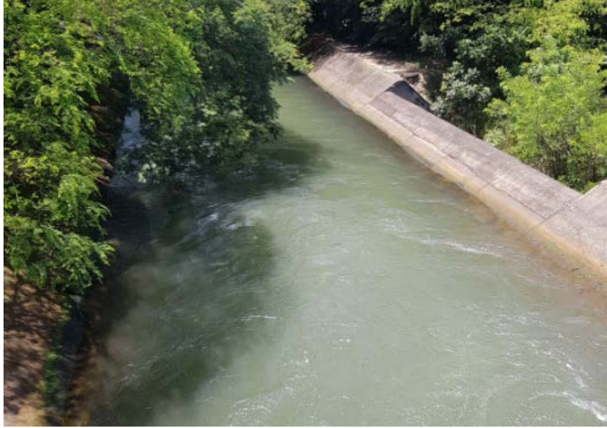
Figura 21. Ejemplo de vertedor de excedencias utilizado en el DRAT en tramo paralelo a cauce de un río.
