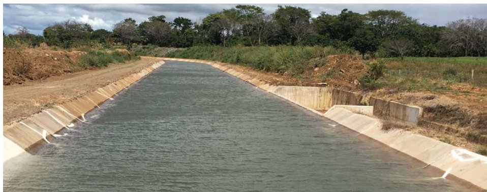
Figura 20. Ejemplo de vertedor de excedencias utilizado en el DRAT en tramo alejado del cauce.
