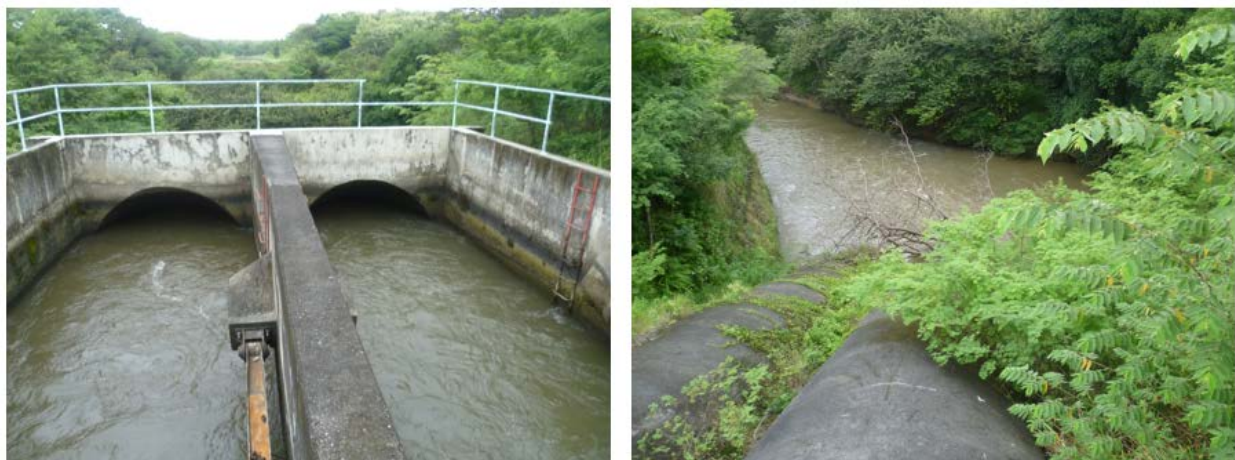
Figura 13. Entrada y ductos de un sifón invertido de dos tuberías de concreto utilizado en el DRAT.
